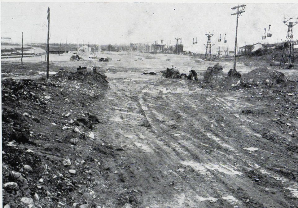
Estado actual de la gran explanada en la que se montará la estación clasificadora.
